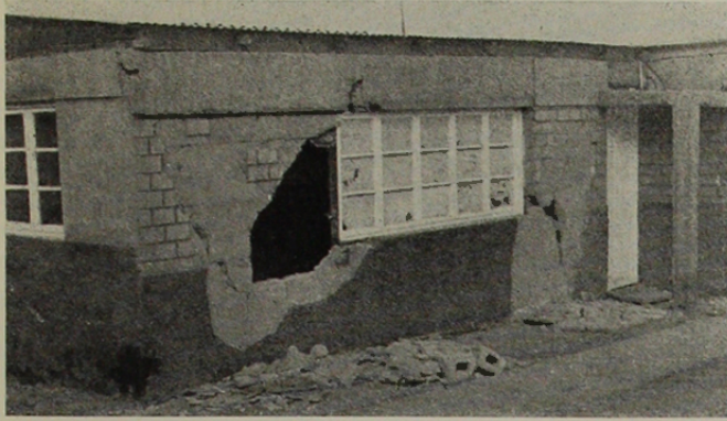
5 Población Santiago Amengual. Como éste, muchos paños de albañilería de bloques se destruyeron.
