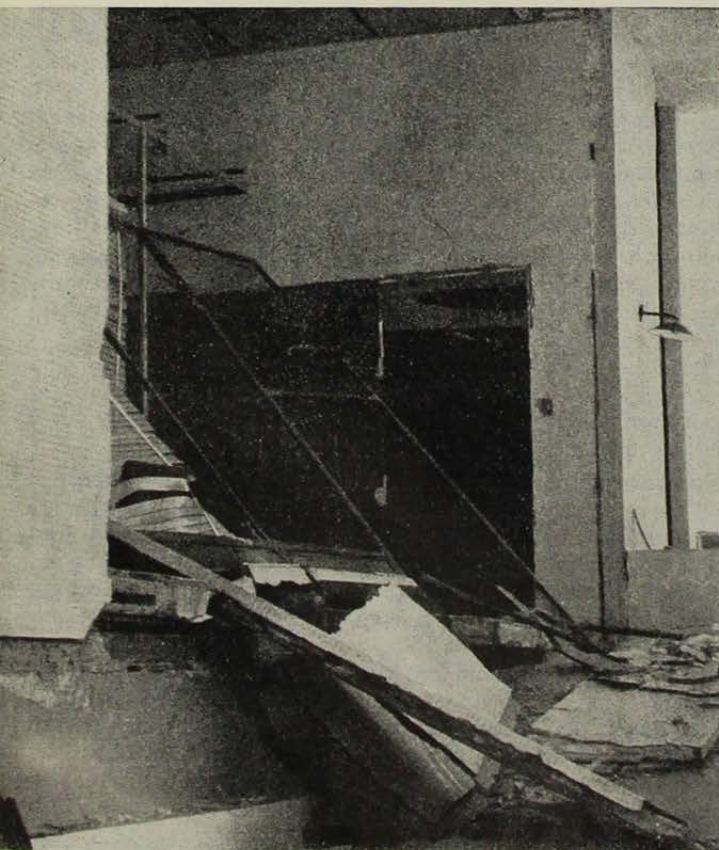
6 Edificio de la Compañía de Teléfonos. El ventanal fue arrancado de su sitio, por deficiencias de anclaje. El antepecho se derrumbó por no existir una solución de unión con el resto de los muros. El limpio corte así lo demuestra. (Foto arqto. E. Orellana).
